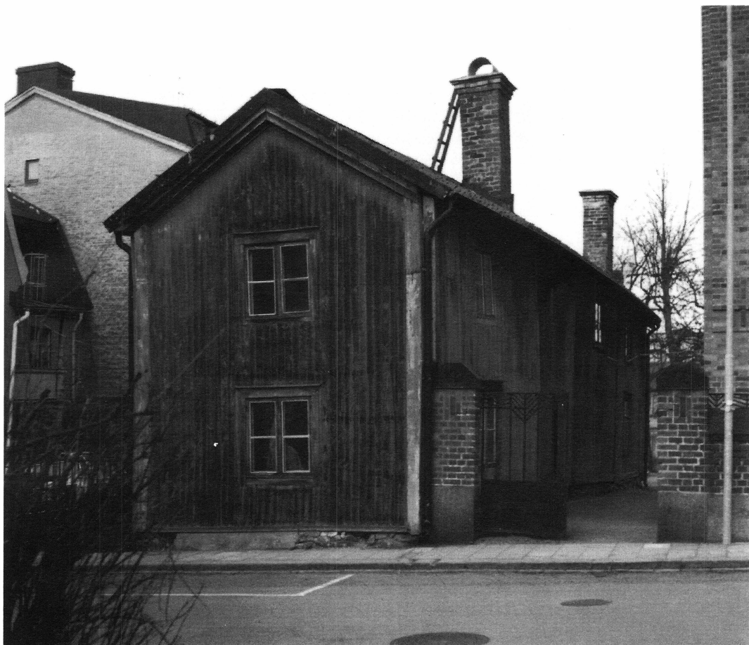
Vy från söder, i förgrunden Rundelsgränd. Den del av huset som ligger närmast lutar kraftigt mot gränden. Det beror på sättningar i marken, och på att denna del aldrig blivit ordentligt sammanbyggd med husets äldsta del. Foto: Anders Franzén.
